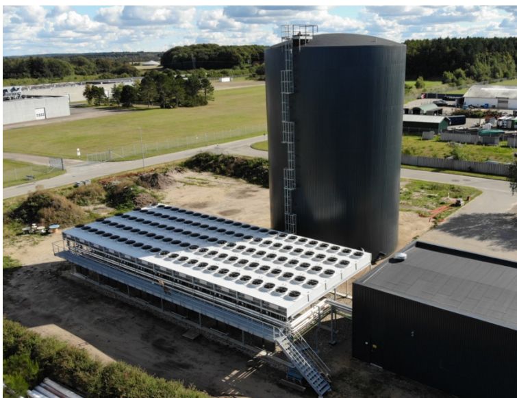
Figur 5: Et eksempel på et luft-til-vand varmepumpeanlæg på 3,5 MW fra Sdr. Felding Fjernvarme
